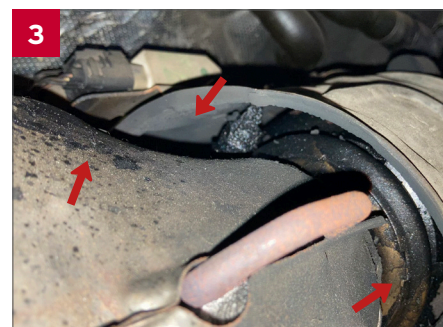
3 Die Auspuffschelle ist undicht, deutliche Rußablagerungen auf und unter dem Hitzeschutz sowie deutliche Ölübertritte infolge des eingeschränkten Rücklaufes
